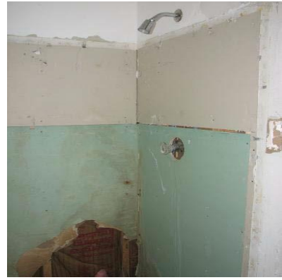
Uso incorrecto en zona húmeda
